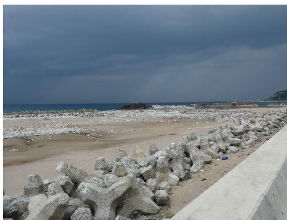
写真7 黒島漁港の地盤隆起の様子
