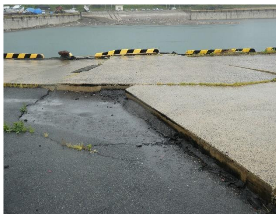
写真10 地盤隆起によるひび割れ
