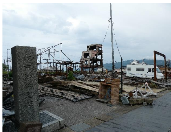
写真12 火災による倒壊した一面の様子 (その2)
