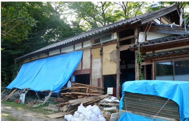
写真2 引き起こしを待つ被災住宅
